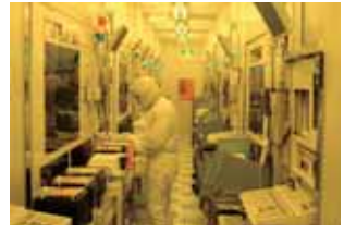
クリーンルームの様子
