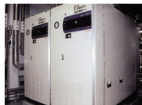
ローム本社の天然ガスボイラー
