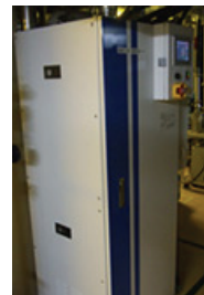
ローム本社に設置されたVOC除害装置
